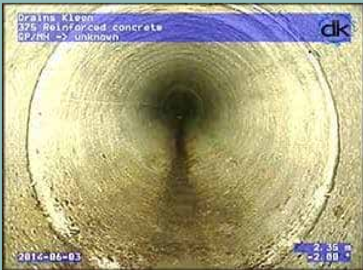
تصویر واقعی ثبت‌شده با سیستم بازرسی متحرک از درون خط لوله [۲]
